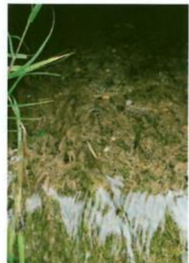
Abwasserpilz im Rohr
