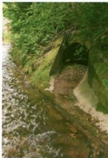
Schlamm durch Rück- stau Bach bei Regen
