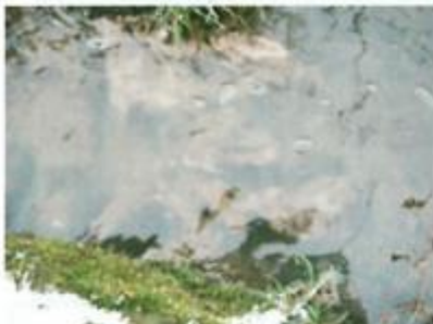
Abwasserpilz an Steinen
